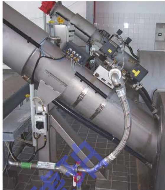
Ro2/RPPS过滤装置配置一体化栅渣冲洗系统
